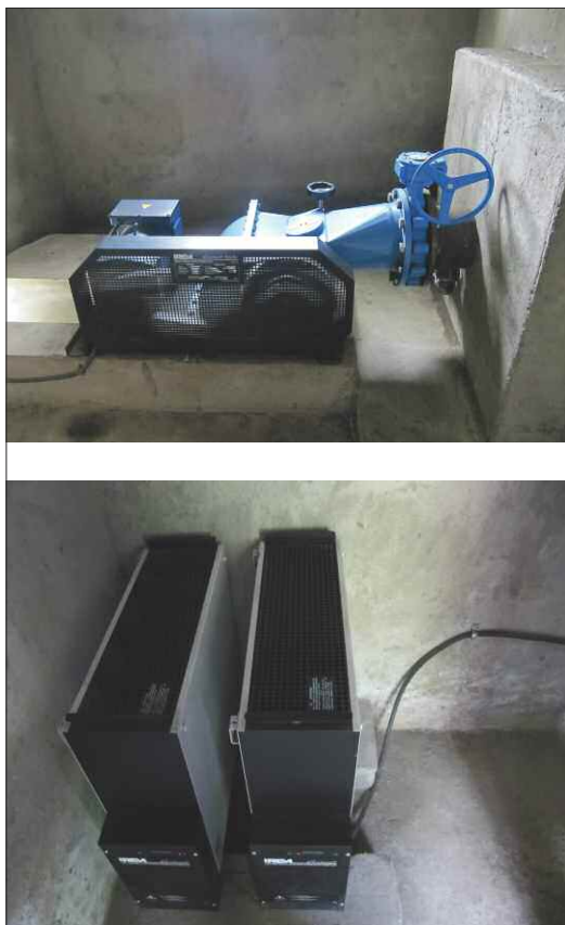
Figura 3 Blocco turbina e generatore – Resistenze zavorra.
